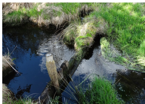
Abbildung 24: Umspülter Holzstau im Hauptgraben. April 2016. Foto: A. EBHART.
